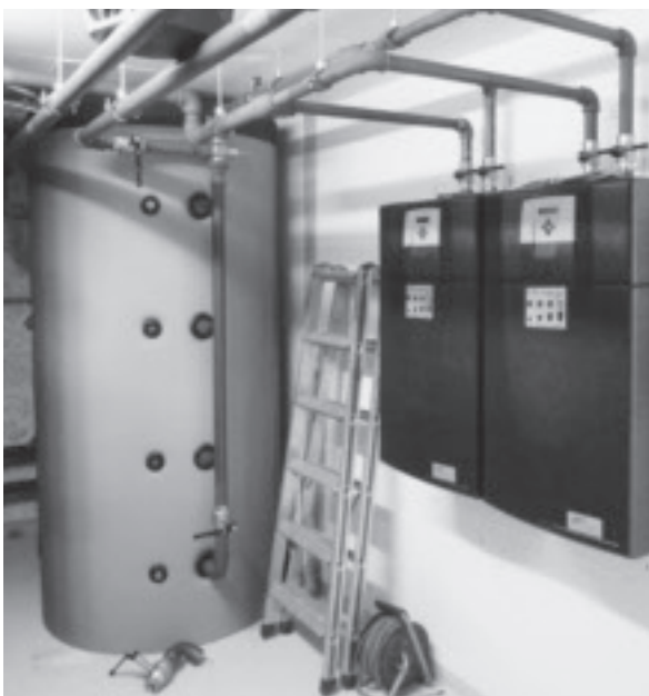
Boiler und Frischwasserstation
